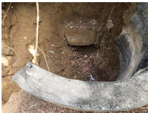
Le puits de 2006 s'est effondré du fait des pluies exceptionnelles, du jamais vu à N'Diagamba
