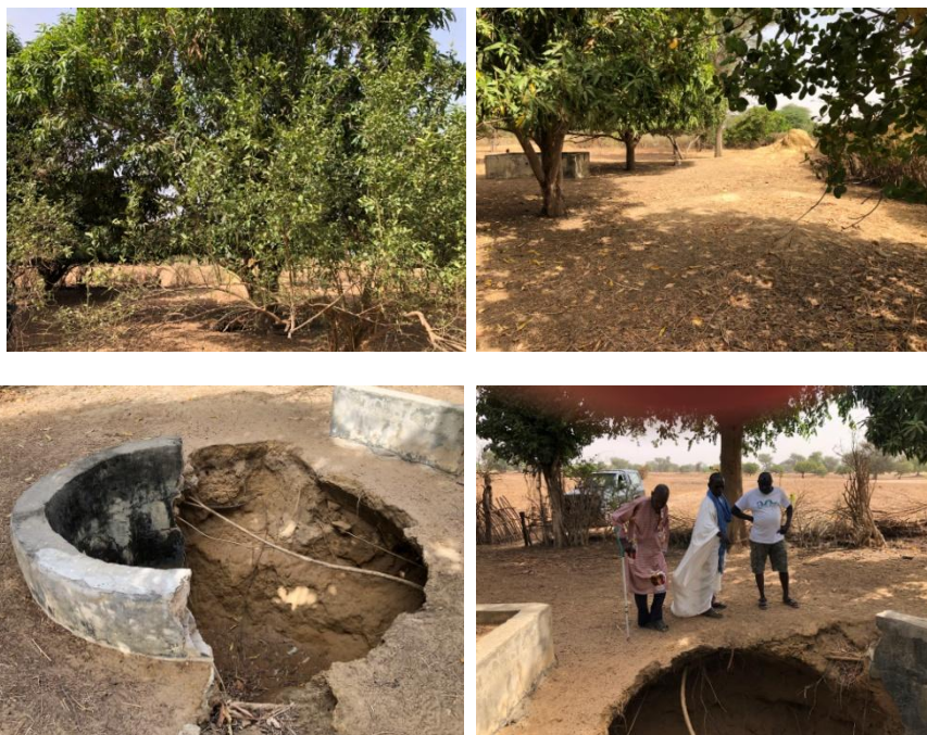
Comme vous le voyiez le puits de 2006 s'est effondré du fait des pluies exceptionnelles, du jamais vu à N'Diagamba
